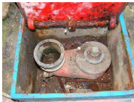
Bouche Incendie de 80 mm à raccord Keyser
