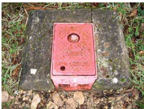
Bouche de lavage fermée
